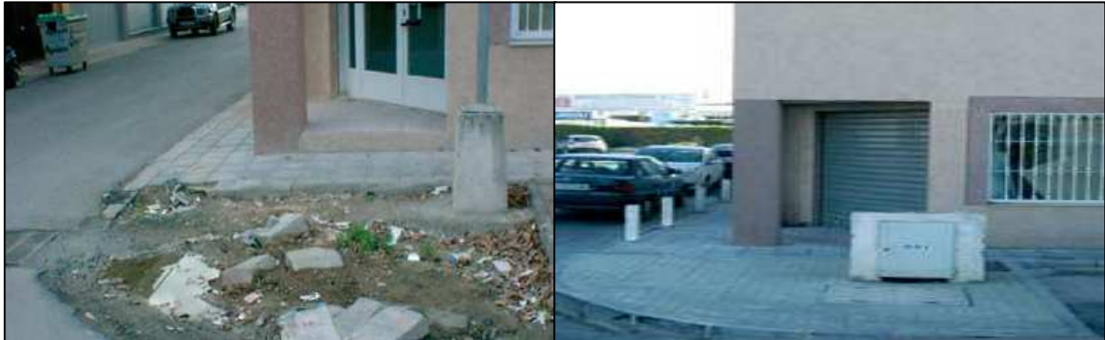
Foto 13. Aceras en mal estado y su posterior arreglo.
